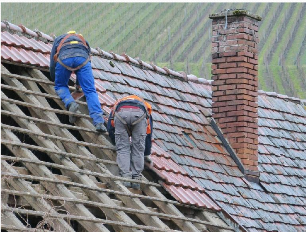
Ein Dach ist nicht mehr sicher. (Bau)Ordnungsbehörden können Einschreiten, wenn eine Gefahr droht.
